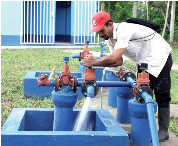
El BCIE financia el Programa de Saneamiento de los Distritos de Arraján y La Chorrera de Panamá, que cuenta con fondos de AECID
